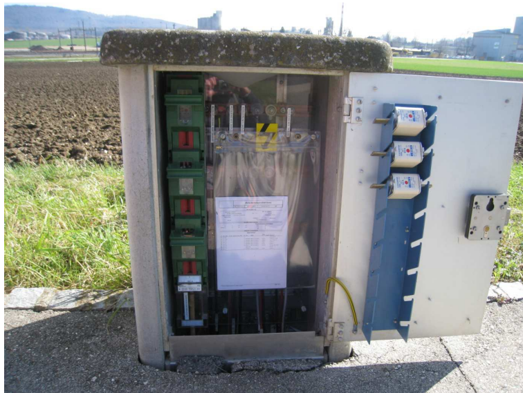
Figure 1 : Armoire de distribution « Ch. des Ecoliers 13 »
